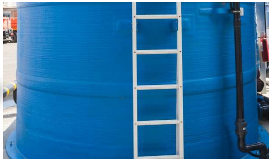
Tanque en fibra de vidrio
